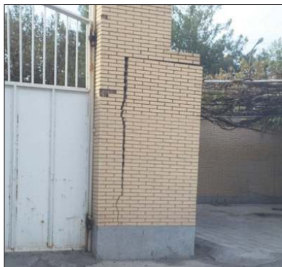
شکل شماره (۳): شکاف در دیوار منزلی در شهر رفسنجان به علت نشست زمین
